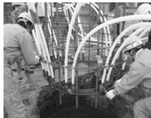
写真-3 熱交換用配管の設置状況 12)
