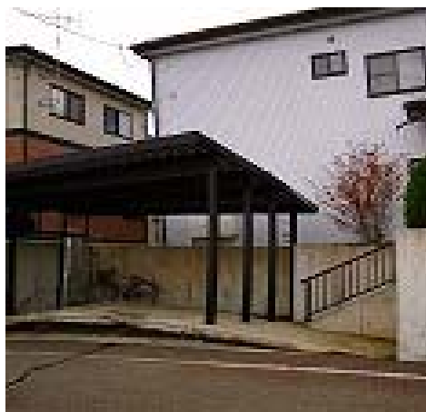
写真2. 住宅の沈下と土間の隆起
