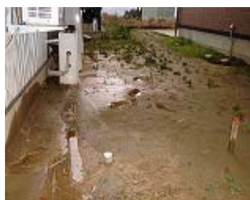
写真3. 宅地内の填砂跡
