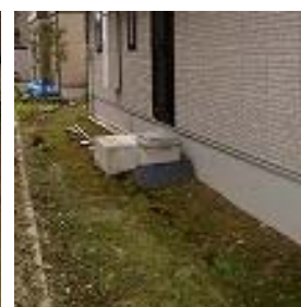
写真4. 敷地の地割れ段差
