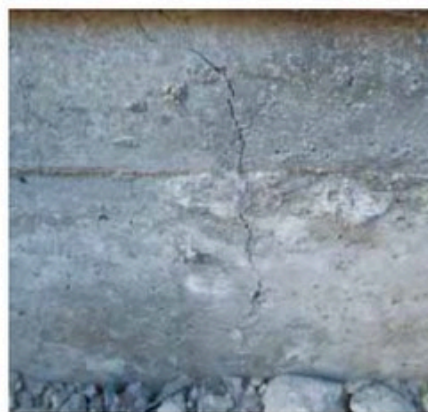
写真-1 建物基礎のクラック
