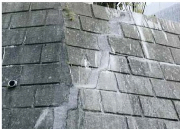
写真-4 注入により擁壁に亀裂が生じた事例（対象宅地は擁壁上部。写真は補修後）
