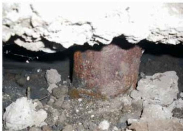
写真-3 鋼管の抜け上がり被害
