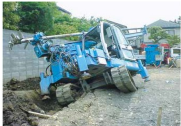
写真-4 障害物撤去後の転圧不足による施工機械の転倒
