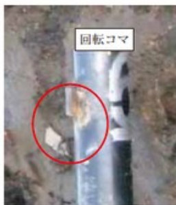
写真-2 回転コマの損傷
