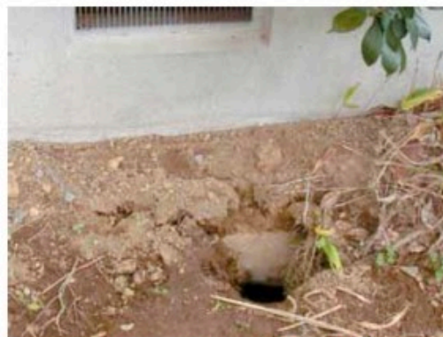
写真-6 建物周囲の陥没箇所状況
